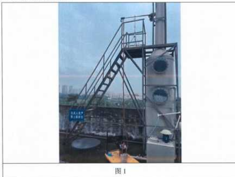
附图 3：废气治理设施图片
